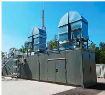
BHKW in der Anlage des Zwickauer Heizkraftwerks
